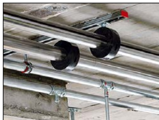
Крепление инженерных сетей
